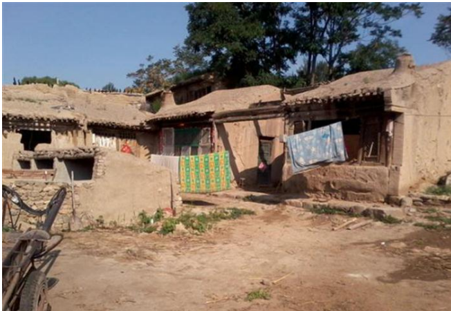
一家人住在快 60 年旧的土木结构平房里。每逢下雨到处都要漏水。
